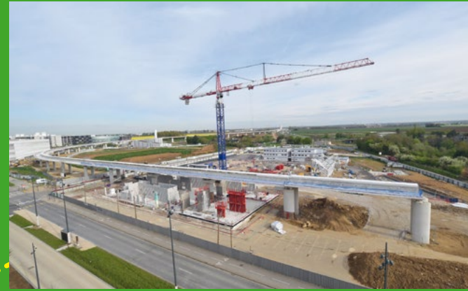
À Orsay-Gif, la construction des murs de la gare a commencé en avril 2023.
